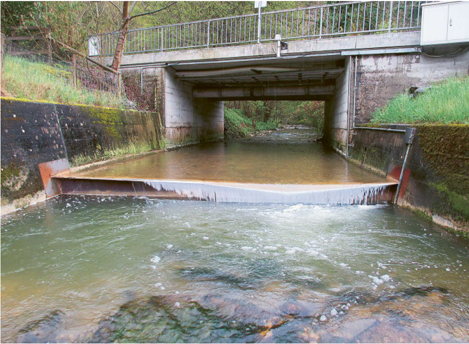
Barrière à écrevisses sur l'Etzgerbach (AG). Le comportement des écrevisses équipées d'un émetteur peut être suivi grâce à une antenne posée sous un pont.
